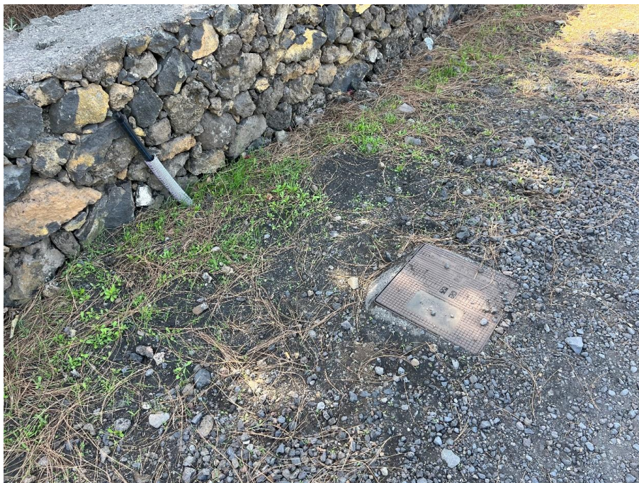
Imagen 6. Arqueta a recrecer con tapa e instalaciones existente.
