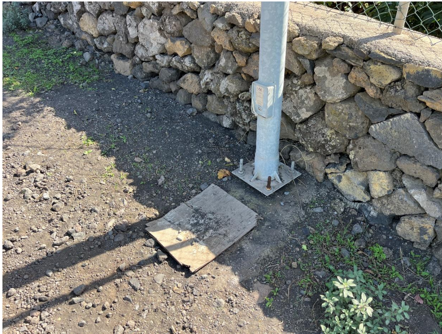
Imagen 5. Alumbrado público existente y arquetas a recrecer sin tapa.
