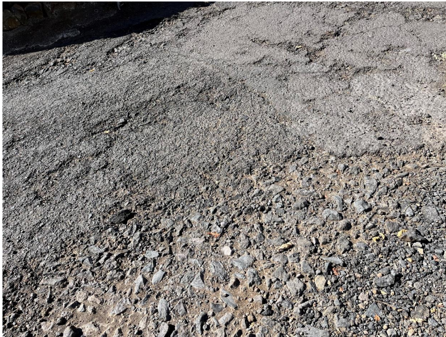
Imagen 6. Estado del pavimento actual.
