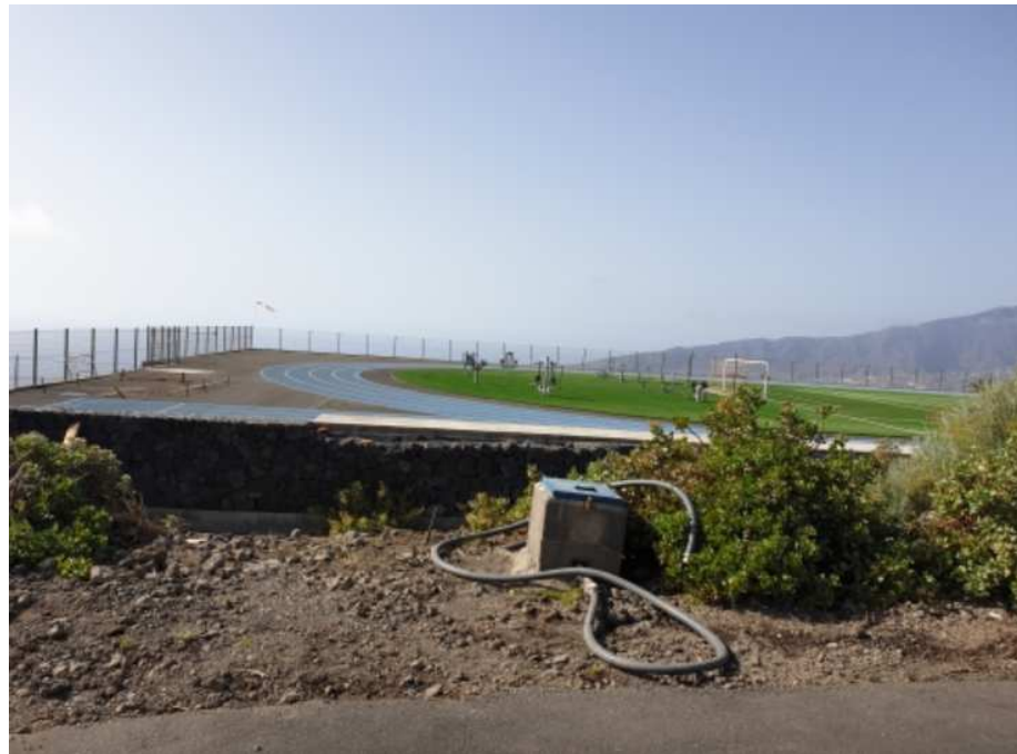
FOTOGRAFIA 6 Hidrante en Pabellón Federico Simón
